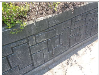
18 진입부 옹벽 균열 STA.0+040(2.0mm/1.2m)
