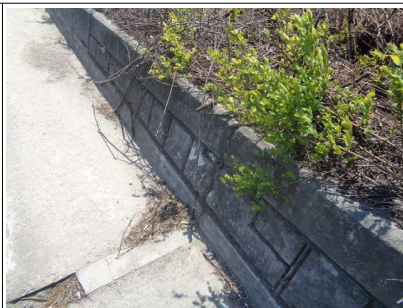
20 진입부 옹벽 균열 STA.0+055(2.0mm/0.6m)
