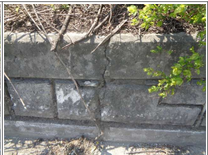
21 진입부 옹벽 균열 STA.0+055(2.0mm/0.6m)
