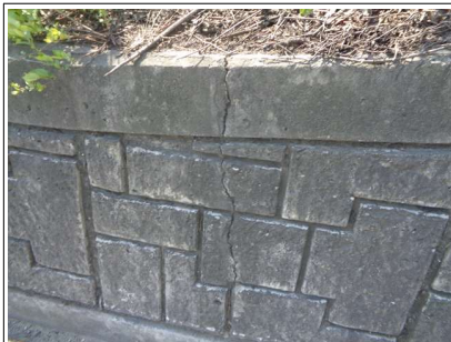
19 진입부 옹벽 균열 STA.0+040(2.0mm/1.2m)
