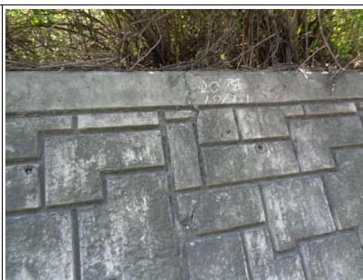
17 진입부 옹벽 균열 STA.0+020(1.0mm/2.1m)
